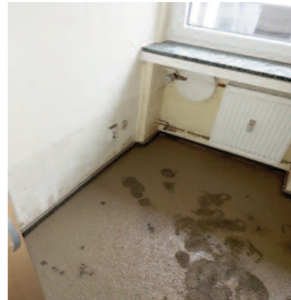
Die Außenstelle Bad Neuenahr nach der Flut am 16. Juli 2021
